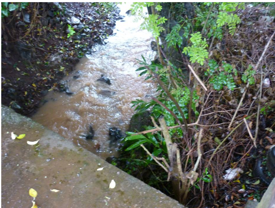
Figura 46: Confluência de tubulações de drenagem e ponto de estrangulamento no Rio dos Micos
