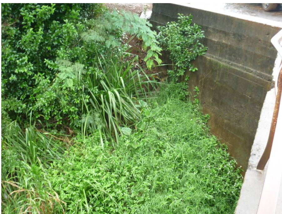
Figura 44: Ponto de estrangulamento na ponte no Rio Erval Fonte: Consórcio SOTEPA/IGUATEMI/AR
