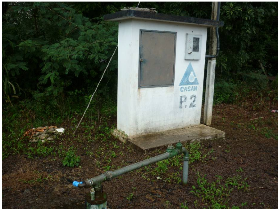
Figura 28: Captação subterrânea de água bruta no Poço 02 Fonte: Consórcio SOTEPA/IGUATEMI/AR
