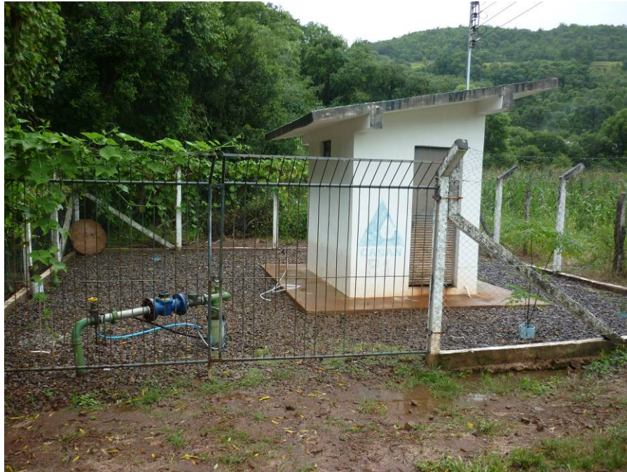
Figura 27: Captação subterrânea de água bruta no Poço 01 Fonte: Consórcio SOTEPA/IGUATEMI/AR
